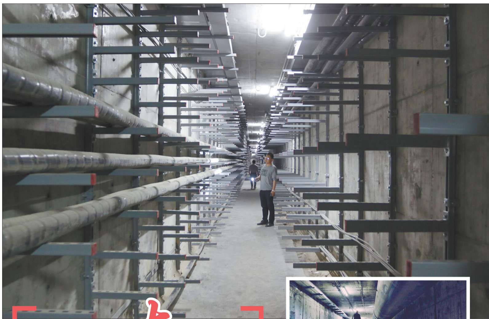
古城快速路已投用的地下综合管廊线缆舱内景
