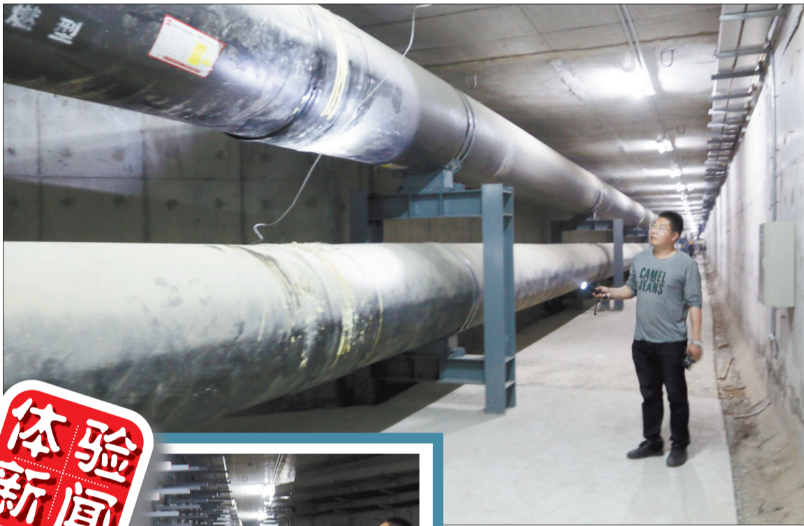
部分地下综合管廊水舱内，供热管道已“入住”
