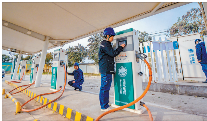
连霍高速洛阳服务区的新能源汽车快速充电站 记者 鲁博 摄
