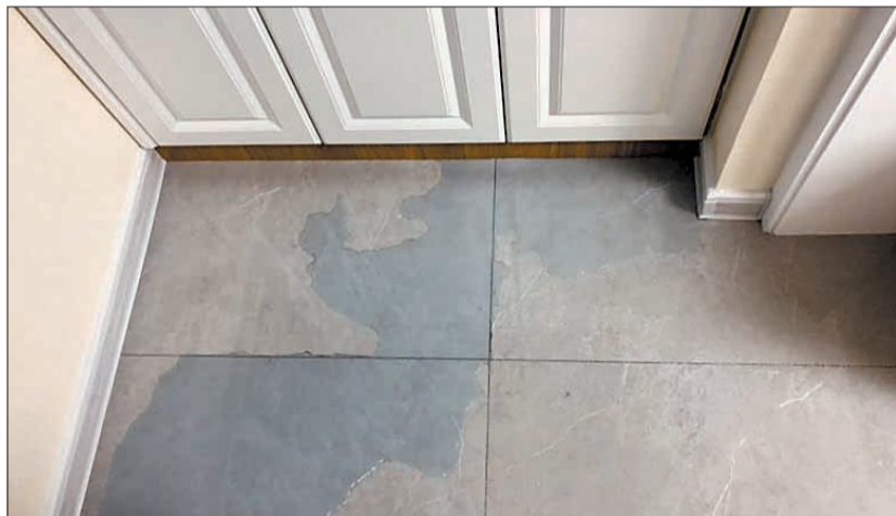
污水从装修过的柜子里流出来(徐先生供图)
