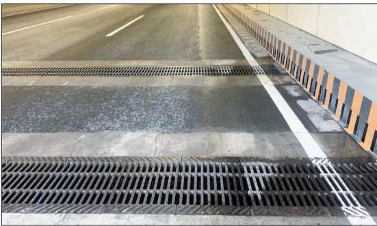
古城快速路隧道入口处配备的排水设备
