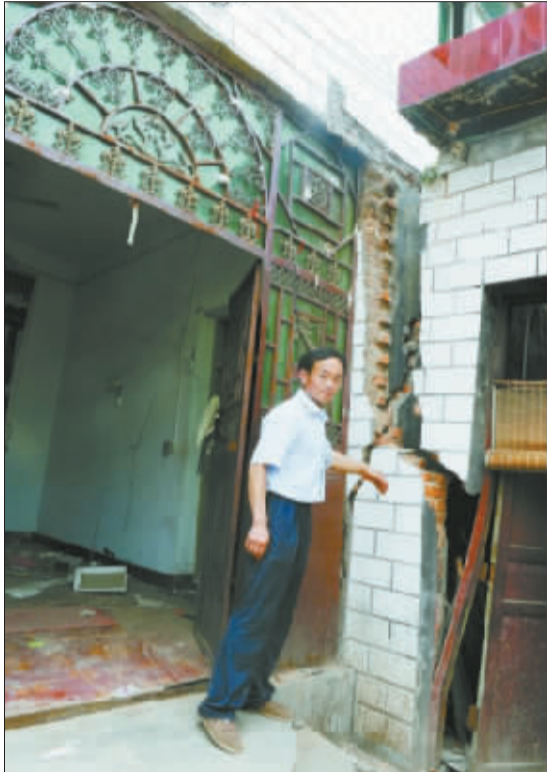
村民的房子墙体开裂,看上去像经历了一场地震。
